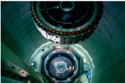
水力発電設備
