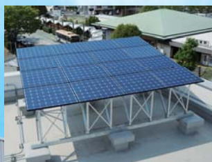
屋上の太陽光発電システム
