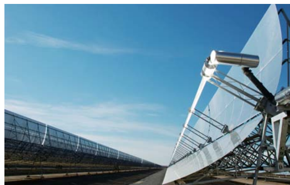
ソラコール太陽熱発電事業（写真提供：アベンゴア・ソーラー社）
