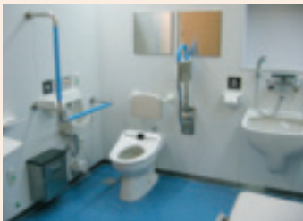
武蔵小杉支店に設置したお客さま用「多機能トイレ」
